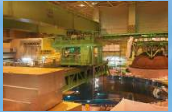
柏崎刈羽原子力発電所6号機における燃料装荷
